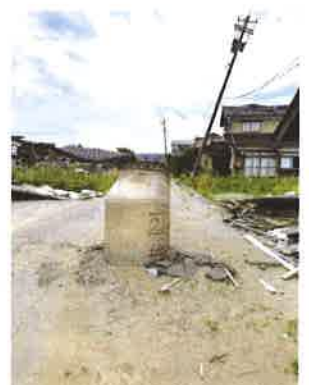
隆起したマンホール
